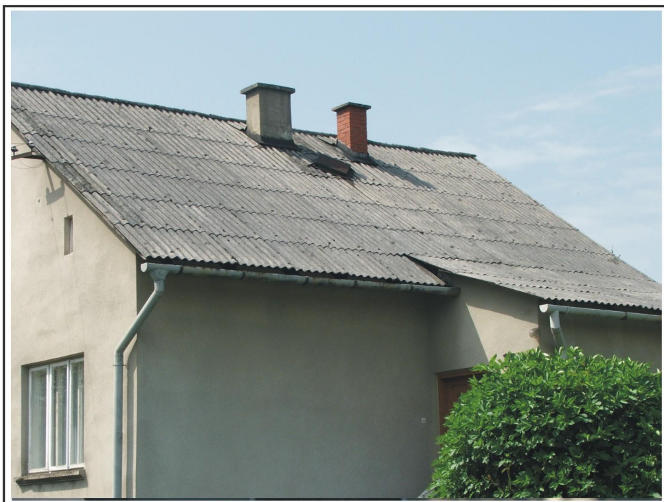
Fot.3 Pokrycie dachowe budynku mieszkalnego z płyt falistych - II stopień pilności
